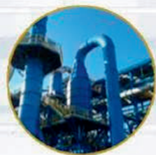
Lavadores de Gases
