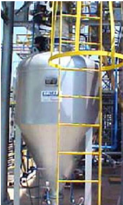
Sistema de Transporte Pneumático Fase Densa para Matéria Prima de Alimentação do Forno de Vidro (Usina de Composição)
