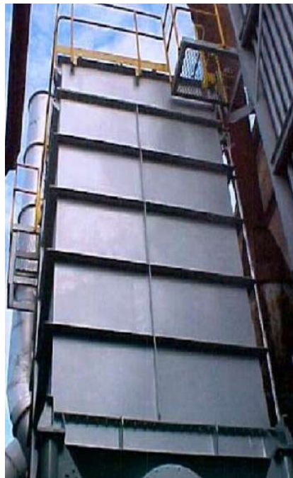
Sistema de Despoeiramento para Fornos de Vidro com Capacidade de 83 T (Fornos 1 e 2) Composto por: 02 Trocadores de Calor TC.2T.6M.126/3/6000, Filtro de Mangas 121S.12.20 TREX, Ventilador Centrífcgo DLM 150-16/8 com Motor de 125 CV, Painel Elétrico, Rede de Dutos, Volume de Exaustão: 33.000 m³/h
