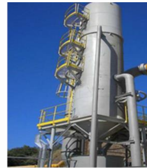
Lavagem de Gases para Forno de Cal
