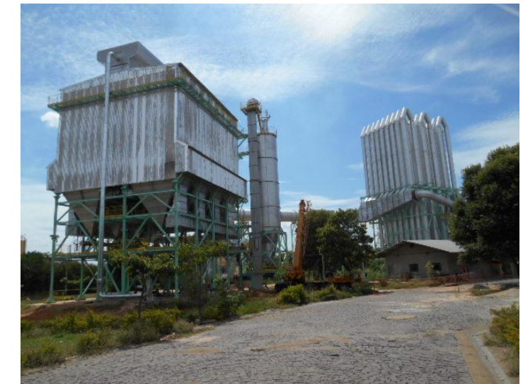
Forno de Silício Metálico Trocador de Calor antes do Filtro de Mangas
