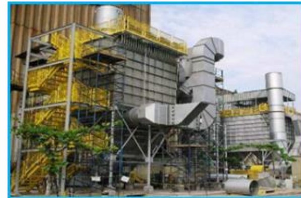
Despoeiramento dos Conversores - Siderurgia
