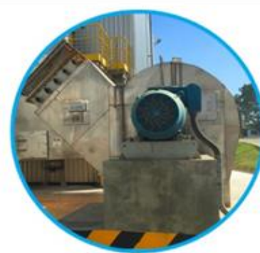
Despoeiramento Forno de Vidro
