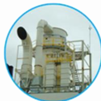
Câmara de Expansão e Air Lifts
