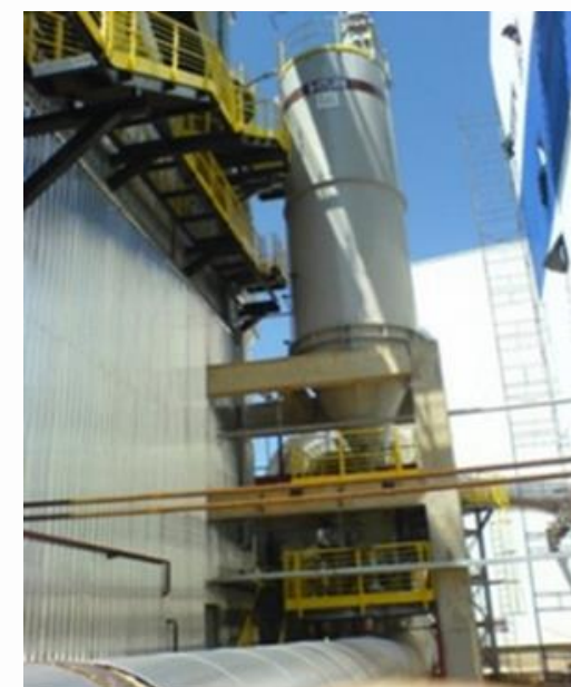
Forno de Vidro Torre de Reação Via Seca, uso de \text{Ca(OH)}_2 - Cal Hidratada como Reagente
