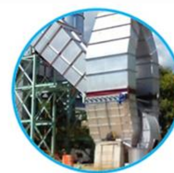
Despoeiramento Forno de Silício
