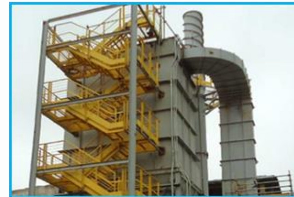
Despoeiramento Moagem Pozolana - Produção de Cimento
