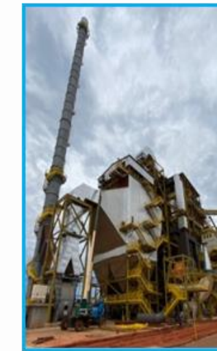
Despoeiramento em Caldeira de Biomassa
