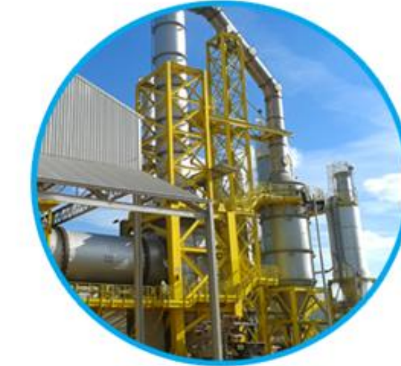
Tratamento de Gases de Incineração
