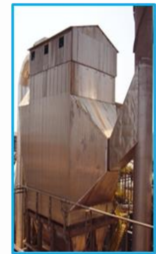
Despoeiramento em Secador de Minério
