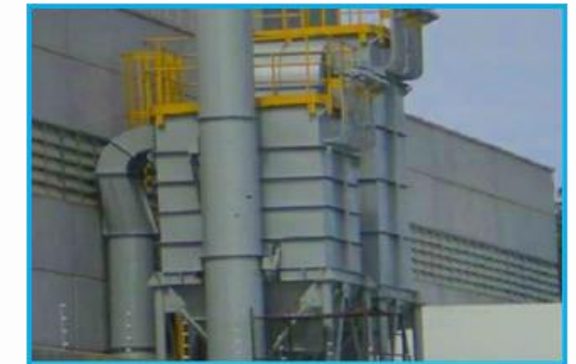
Despoeiramento Gases Gerados Banho de Chumbo
