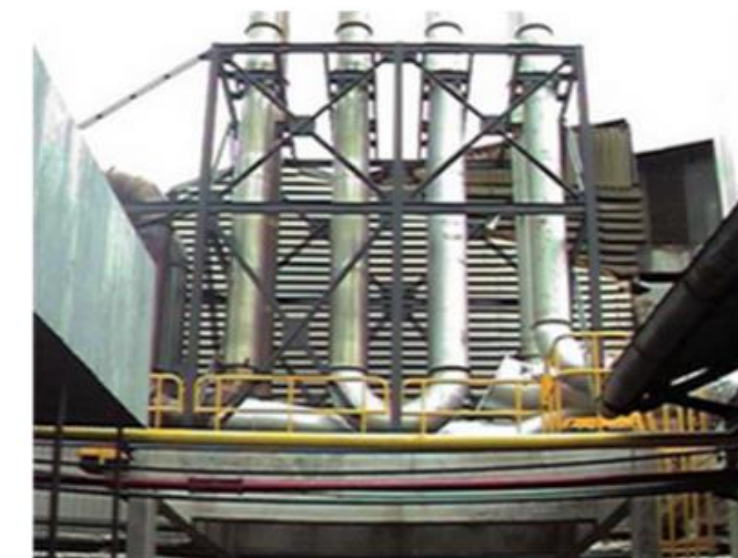
Forno de Fusão de Vidro Trocador de Calor
