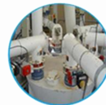
Sistema de Mistura, Dosagem, Pesagem e Preparação de Bateladas
