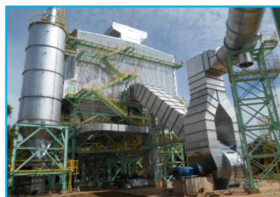
Despoeiramento para Forno de Silício Metálico
