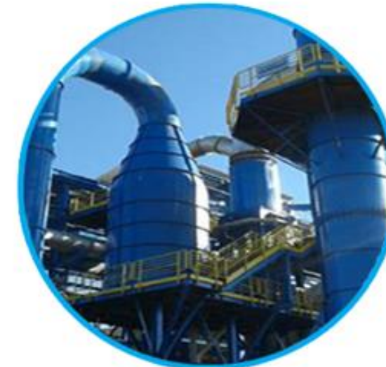
Lavadores de Gases
