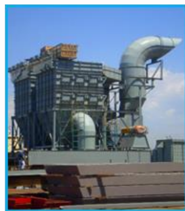
Despoeiramento Skip Loader/ Unloader Expansão Refinaria - II
