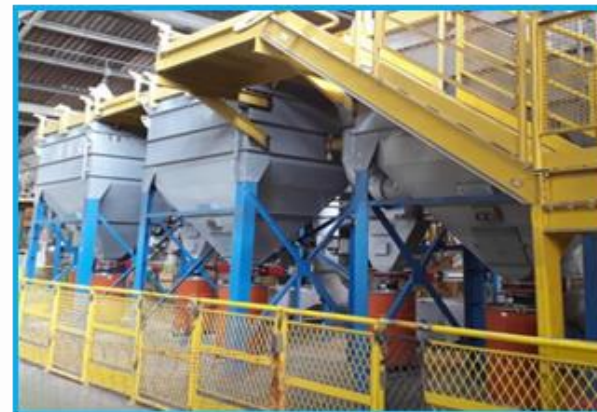
Despoeiramento para Forno de Chumbo, Galvanização e Trefila
