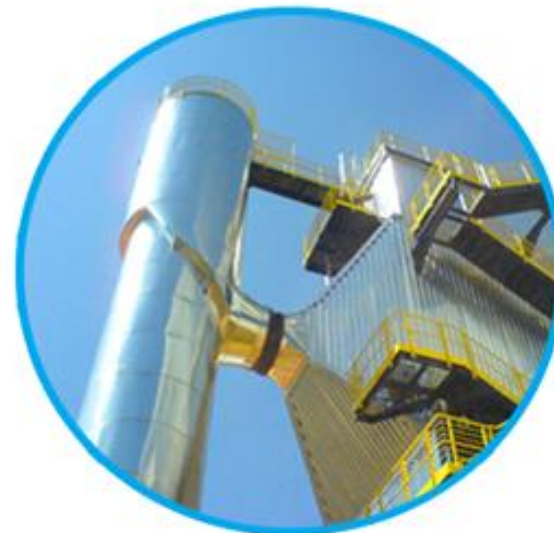
Torres de Condicionamento de Gases
