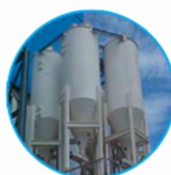
Silos e Acessórios
