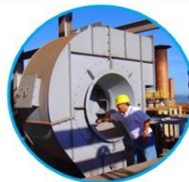
Despoeiramento Secador Minério
