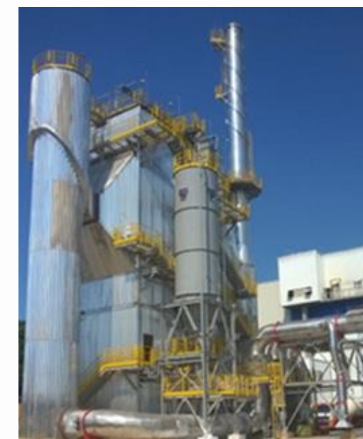
Forno de Vidro Torre de Reação Via Seca, uso de \text{Ca(OH)}_2 - Cal Hidratada como Reagente
