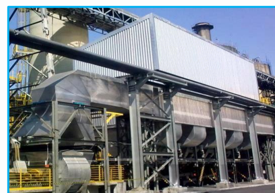
Despoeiramento para Caldeira - Queima de Coque
