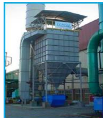
Despoeiramento Cabines de Rebarbação e Jateamento
