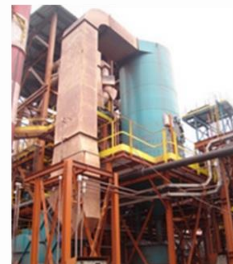
Lavagem de Gases para Usina de Pelotização
